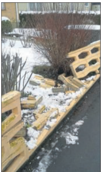
Kaputt: die Mauer in der Hünschen Burg. Foto: Steinbock/hh
